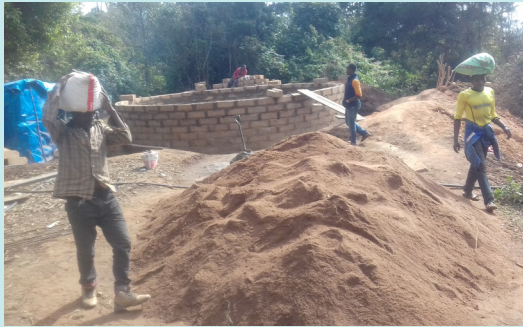
Bouw- en graafwerkzaamheden voor de aanleg van pijpleidingen en een reservoir uitgevoerd door dorpsbewoners.
