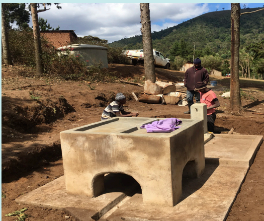
Kledingwastafel, kraan en opvangreservoir (op de achtergrond)
